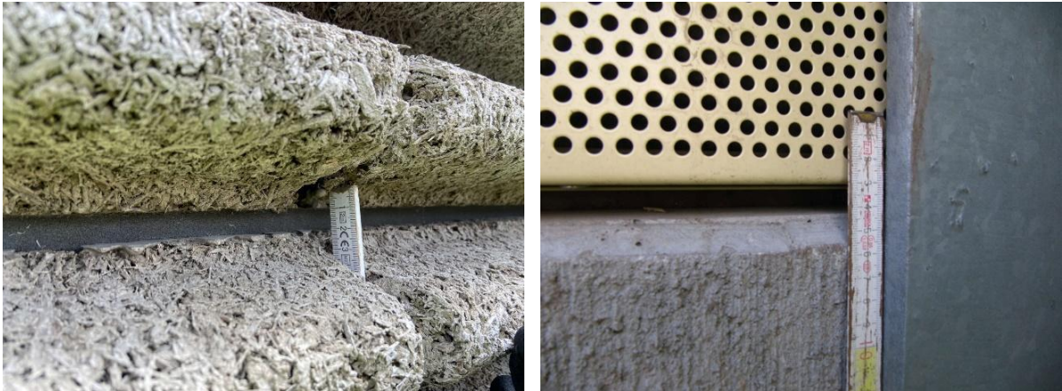
Abbildung 7: Optische Auffälligkeiten der Kategorie 2 aufgrund eines herausstehenden Dichtungsbandes (linkes Bild) bzw. eines Ausbruchs am Sockel mit übermäßig expandiertem Dichtungsband (rechtes Bild).
