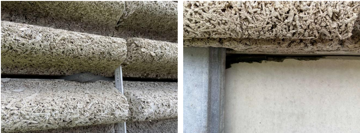
Abbildung 8: Optische Auffälligkeiten der Kategorie 2 aufgrund eines herausstehenden Dichtungsbandes (linkes Bild) bzw. eines Ausbruchs am Sockel mit übermäßig expandiertem Dichtungsband (rechtes Bild).
